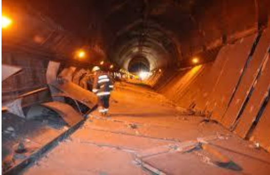
トンネル壁面の崩落事故
