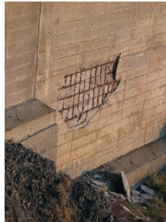
鉄筋の腐食で剥落した擁壁
